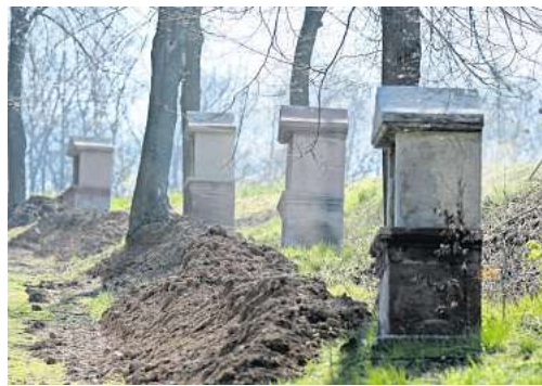
Der Kreuzweg in Immingerode wird saniert – neben Erdarbeiten muss auch der Sandstein ausgebessert oder erneuert werden.
